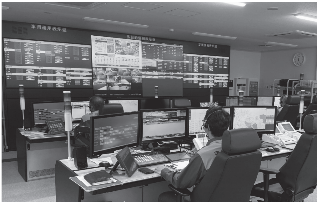
高機能消防指令センター
