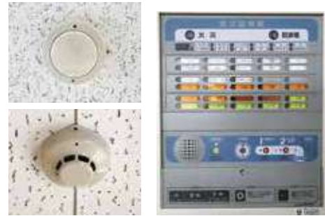
①② 自動火災報知せつび
