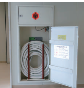
④ 屋内消火栓の中の様子
