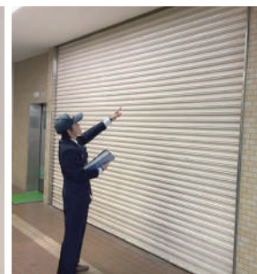
⑤ 防火シャッター
