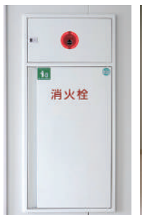
④ 屋内消火栓
