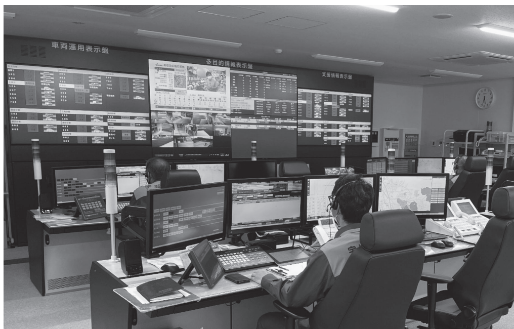
高機能消防指令センター
