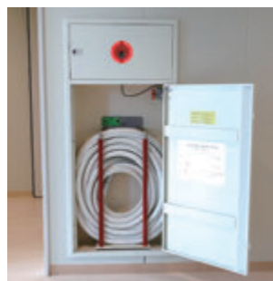
④ 屋内消火栓の中の様子
