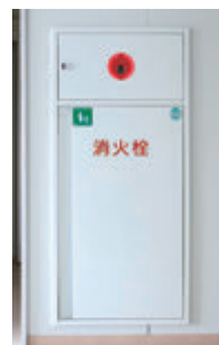
④ 屋内消火栓
