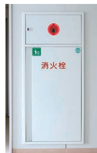
④ 屋内消火栓
