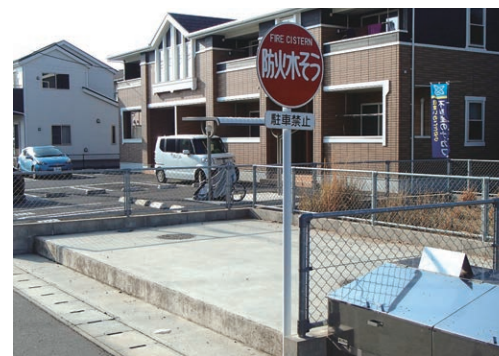
防火水そうと標識
