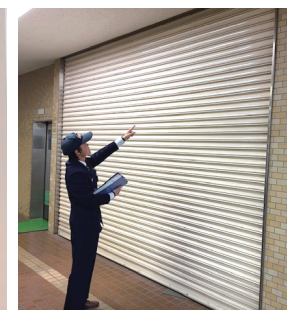
⑤ 防火シャッター
