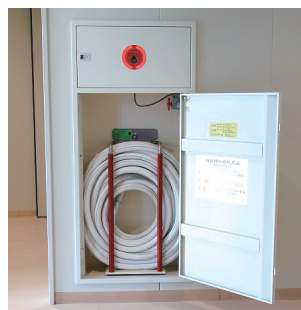
④ 屋内消火栓の中の様子
